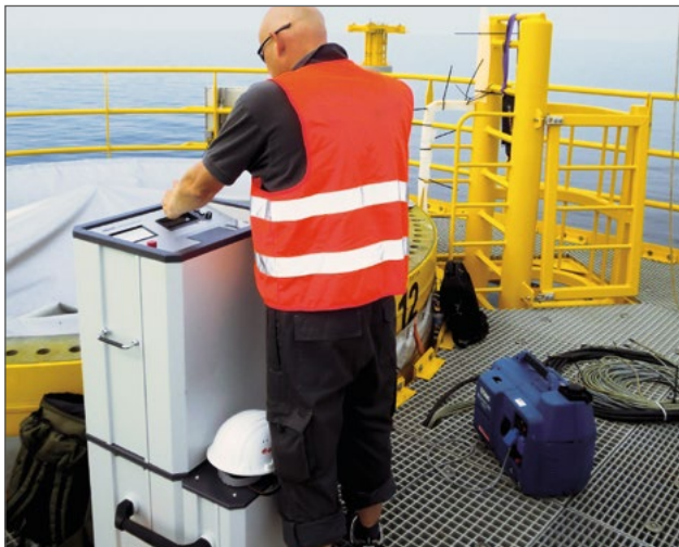
VLF CR-60 кВ в експлуатації на ВЕС «Балтика 1» (Балтійське море).
